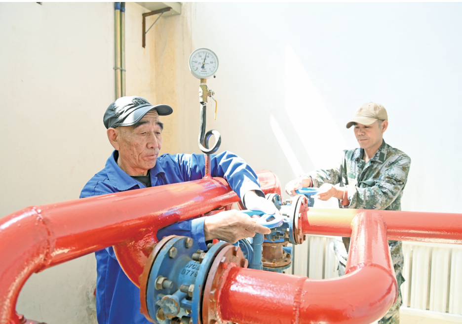
工作人员在检查隆府尚苑小区的消防泵房。
