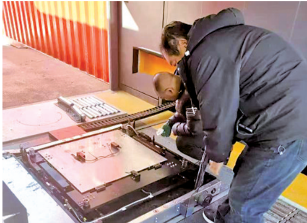
工作人员正在为换电站设备进行维护。
