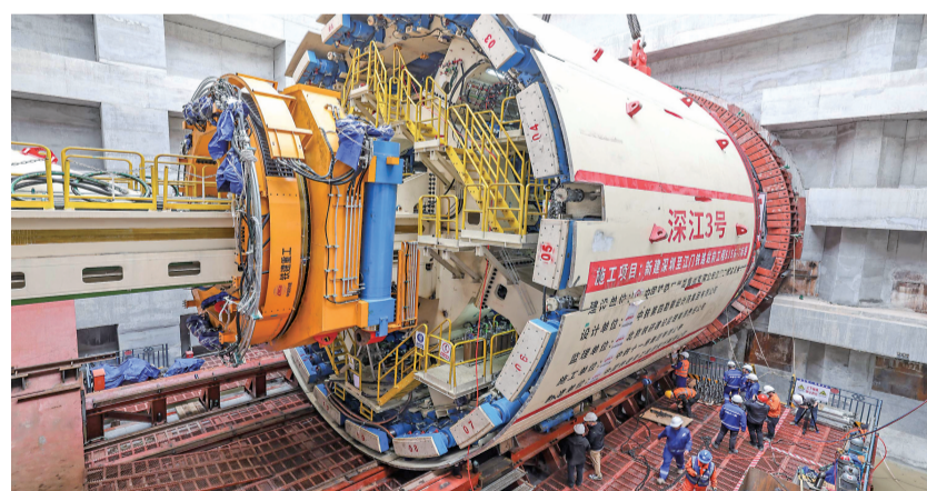
2月28日,施工人员在吊装现场调整“鲲鹏号”盾构机的刀盘位置。当日,在由中铁十一局承建的深江铁路深隧隧道西段,“鲲鹏号”盾构机刀盘吊装下井,该段是13米级大直径单洞双线隧道。深江铁路是我国“八纵八横”高铁网沿海通道的重要组成部分,正线全长约116公里。新华社记者 刘大伟 摄
