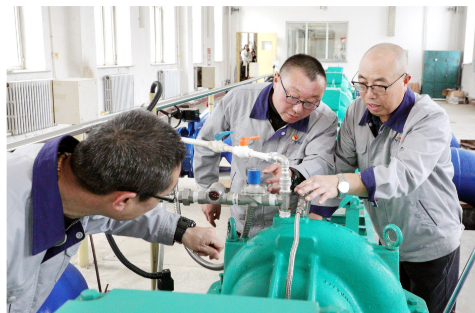
水务集团河滨水厂工作人员对送水泵房新设备进行调试。
