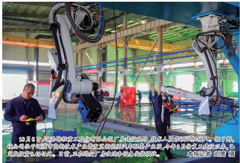
10月8日,辽源锦程重工股份有限公司厂房建设现场,技术人员在调试机器人。据了解,该公司位于辽源市高新技术开发区新能源汽车配套产业园,今年3月份复工复产建设以来,已完成投资0.45亿元。目前,正在进行厂房改造和设备安装调试。本报记者 刘鹰 摄
