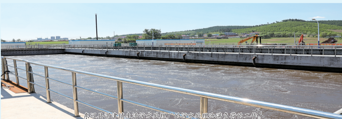
东辽县柳河镇生活污水厂的污水处理池负荷的工作。
