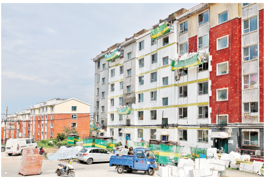
困扰小区居民最难心的“楼房漏水、冬日不暖”难题,正逐步得到彻底解决。
