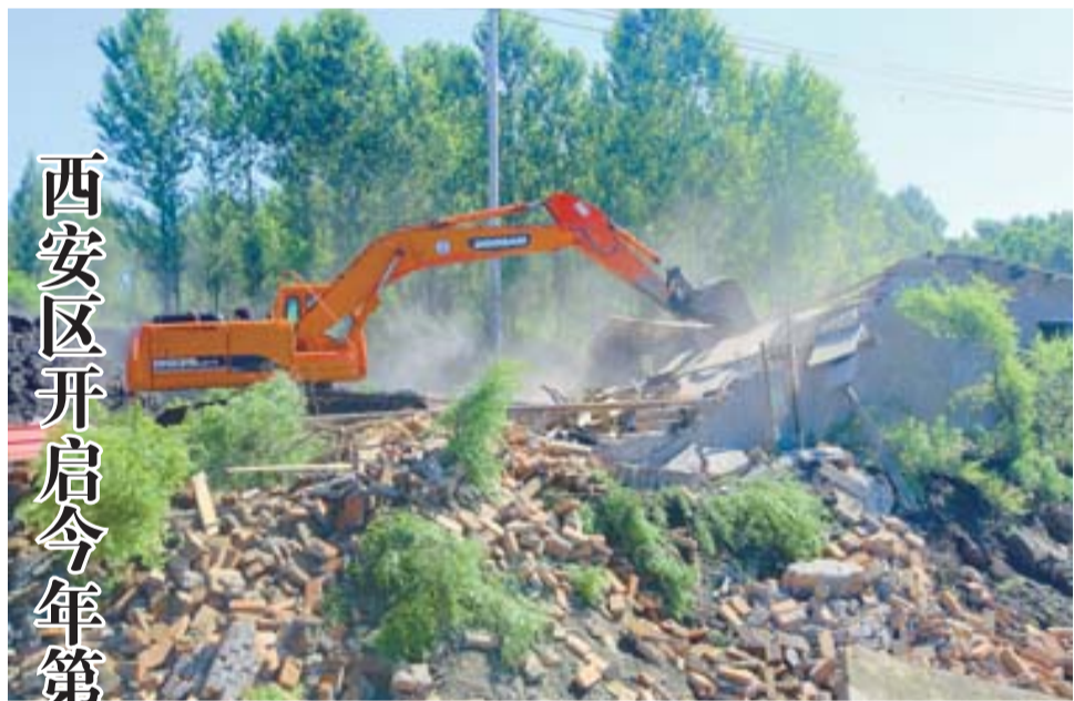
矿山湿地公园项目建设用地灯塔区域的违法建筑被依法强制拆除。
