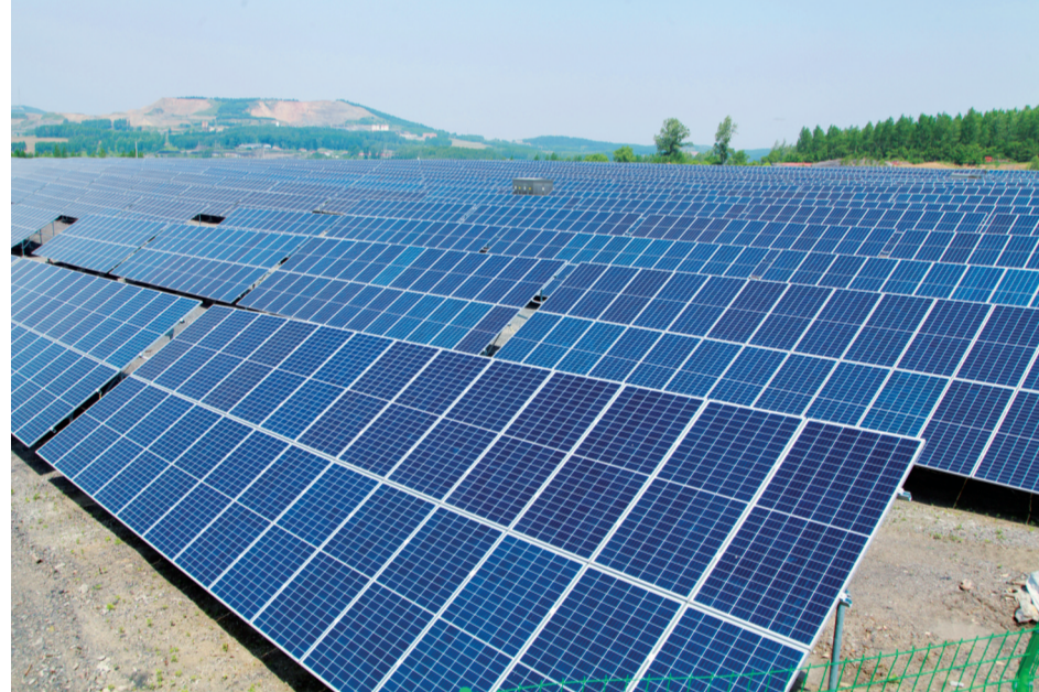
辽矿集团配售电有限公司新能源4兆瓦光伏发电项目。 本报记者 吴培民 摄
