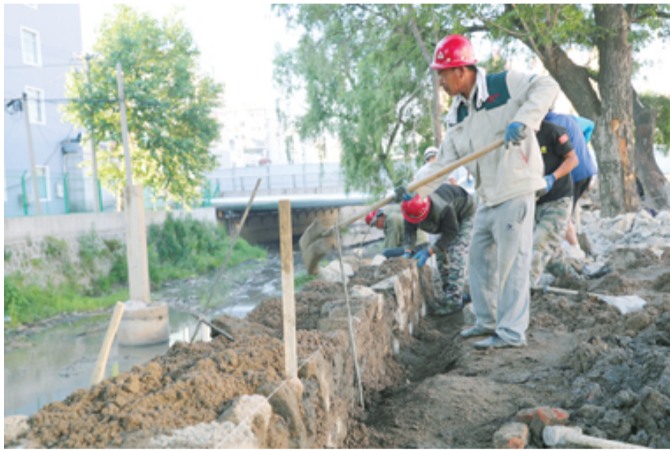
清晨,工人们在仙人河西岸儿童乐园提升改造工程现场施工。 本报记者 夏景明 摄
