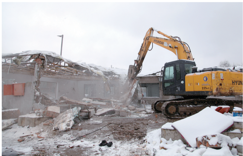
4月22日,仙城客运站西侧仙人河两岸的建筑被依法拆除。 本报记者 张建树 摄
