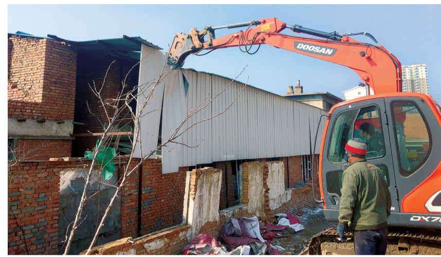
三月十日,执法部门对工农乡农村四组违章建筑进行依法拆除。本报记者 张建树 王延超 摄
