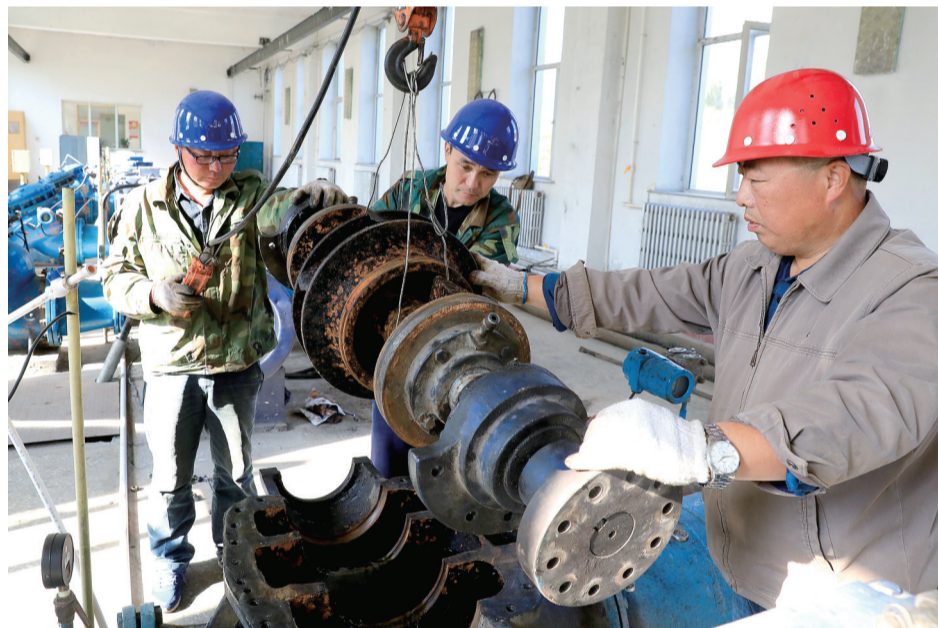
10月14日,河滨水厂职工在检修送水泵。连日来,市水务集团陆续开展水厂供水设备检修维护、二次供水泵房设施养护和水池清洗及供水管线排查等工作,全力以赴应对气候变化,保证制水、供水、送水一路安全、永远畅通,确保全市百姓持续稳定地吃上安全水、放心水。 本报记者 刘鹰 摄
