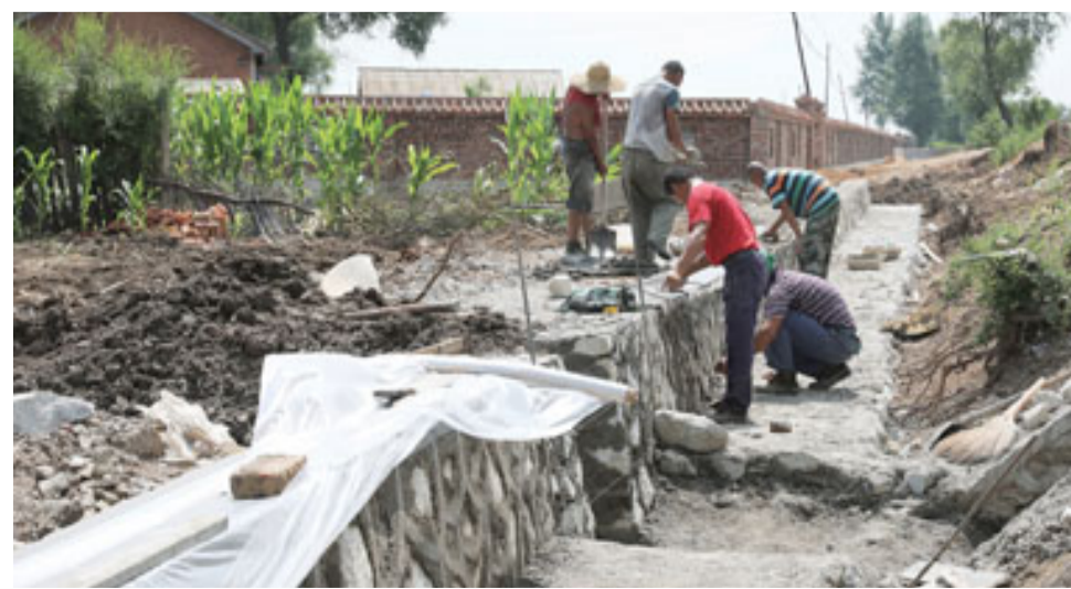
东丰县黄河镇文福村精心打造农村人居环境整治标准示范村屯,村民主动拆除自家不规范的仓房、厕所、棚舍等,为农村人居环境整治作出自己的努力。图为文福村七组村民在公路两侧修建标准化排水沟渠。
