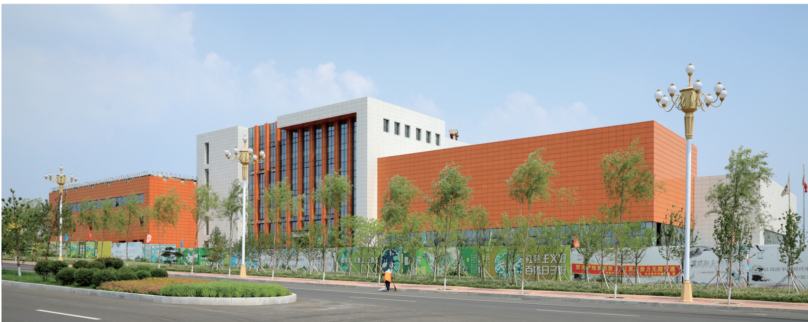
6月27日,总投资1亿多元、占地面积22000平方米的东丰县全民健身中心已进入内部装修及游泳馆、攀岩馆、桌球馆等12个场馆的建设阶段,预计年末将全部完工,给热爱运动的东丰人民提供一个便利的健身场所。 本报记者 刘彦 摄
