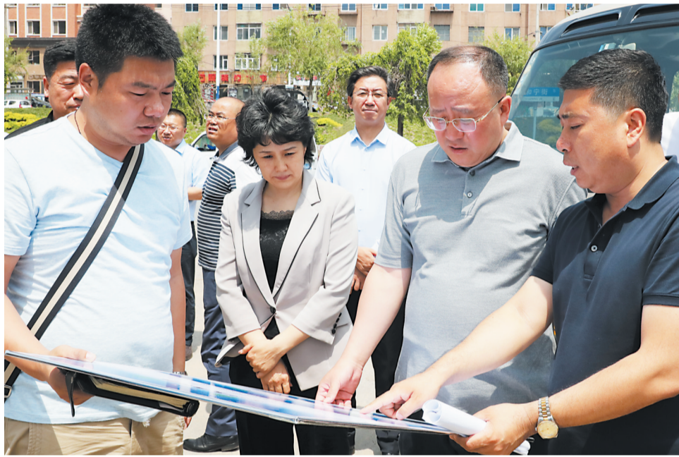
6月12日,市委书记柴伟、市长孙弘率队深入市区13条在建道路及5个环保项目施工现场调研工程进度情况。图为市领导和在宁街调研雨污分流改造项目施工情况。本报记者 夏景明 摄
